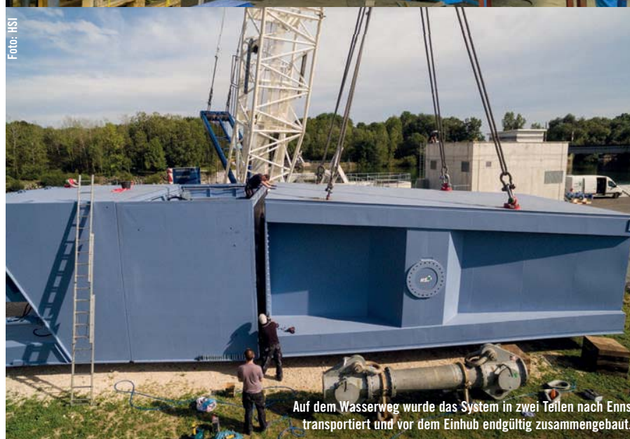
Das bewegliche Kraftwerk wird im HSI-Werk in Trier vormontiert und getestet.
